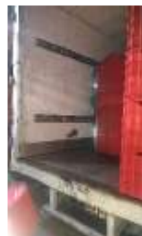
Imagen 3: Lateral inferior del furgón del vehículo placa JOU822
