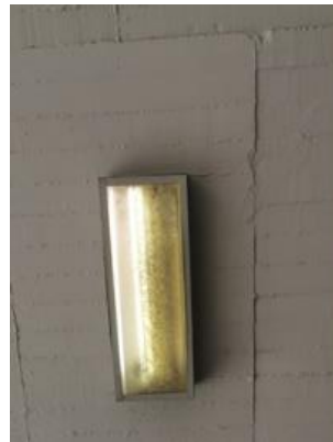
Mantenimiento eléctrico de iluminación en zona de mausoleos. – Cementerio Serafin
