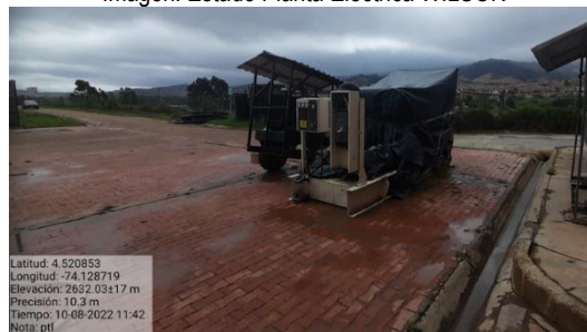
Imagen. Estado Planta Eléctrica WILSON
