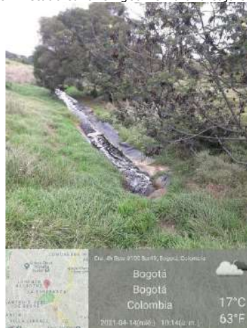
Imagen. Estado canal en geomembrana caja 53 a PTL
