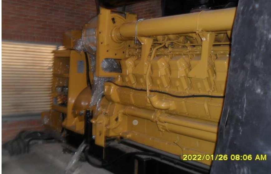
Imagen. Estado Planta Eléctrica
