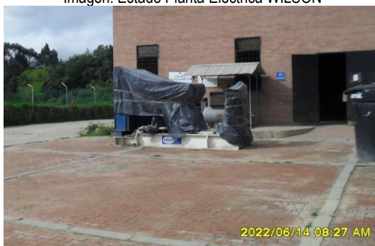
Imagen. Estado Planta Eléctrica WILSON
