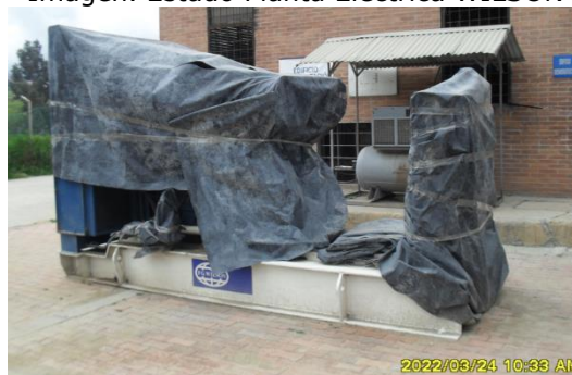
Imagen. Estado Planta Eléctrica WILSON
