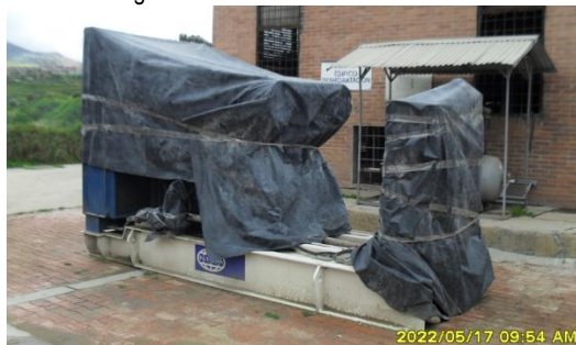
Imagen. Estado Planta Eléctrica WILSON
