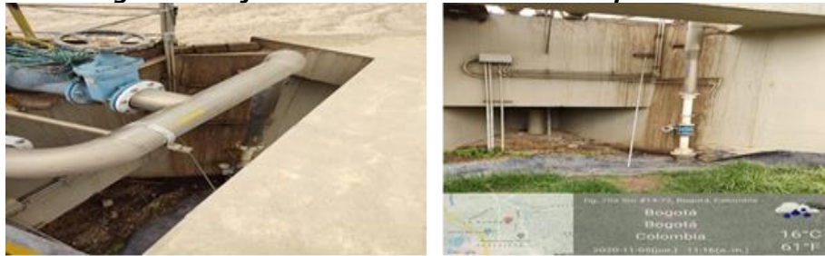
Imagen 2. Zanjones de oxidación Occidental parte frontal
