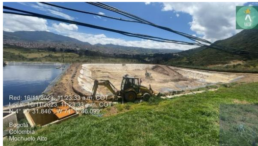
Imagen. Estado Actual de Pondajes II
