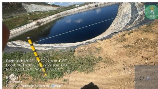
Imagen. Estado Actual de Pondajes II-1
