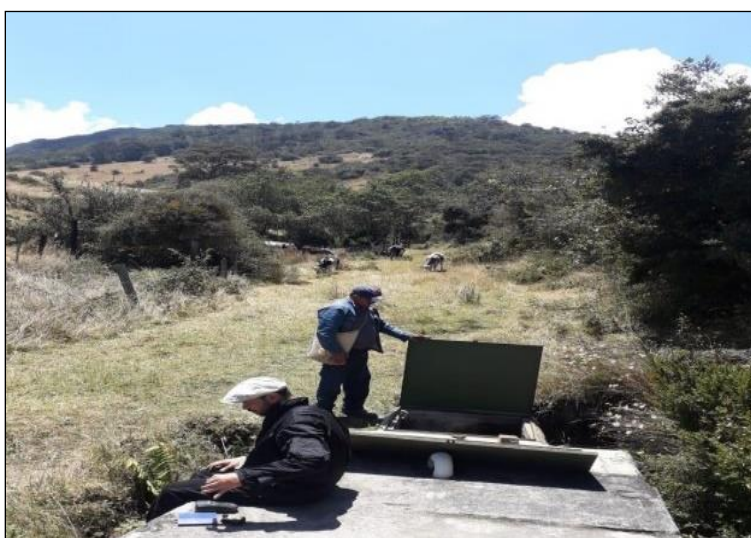
Fotografía 1. Acueducto comunitario ASOPORQUERA
