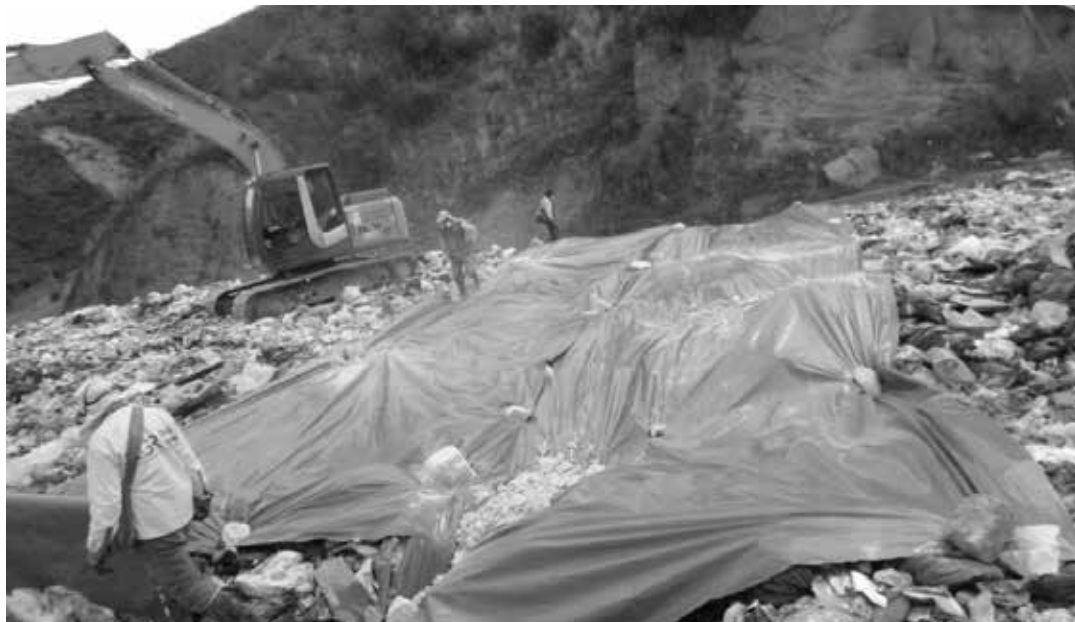
Colocación de cobertura en polietileno sobre los residuos dispuestos en zona II, área 3.
