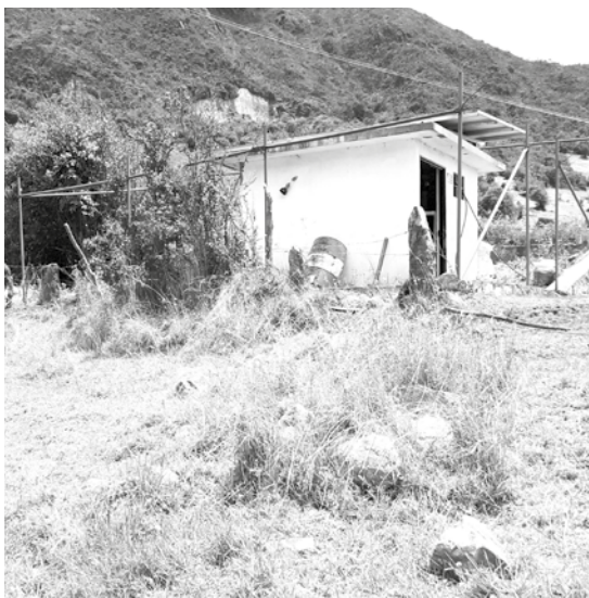
Planta de tratamiento de agua, acueducto comunitario de Mochuelo Alto.
