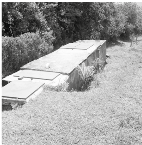
Tanque de reserva Asoporquera II, acueducto comunitario de Mochuelo Alto.
