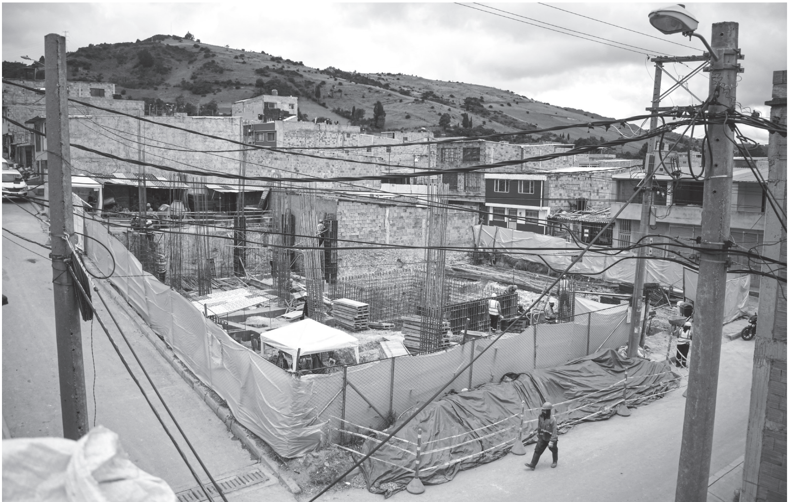
» La construcción del Jardín Infantil y Centro de Desarrollo Comunitario avanza a toda marcha. De acuerdo con el cronograma del constructor, la obra la entregarían en diciembre de este año.
