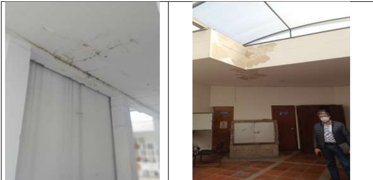
Daños por filtraciones en techos de mausoleos y sala de recepción de hornos crematorios.
