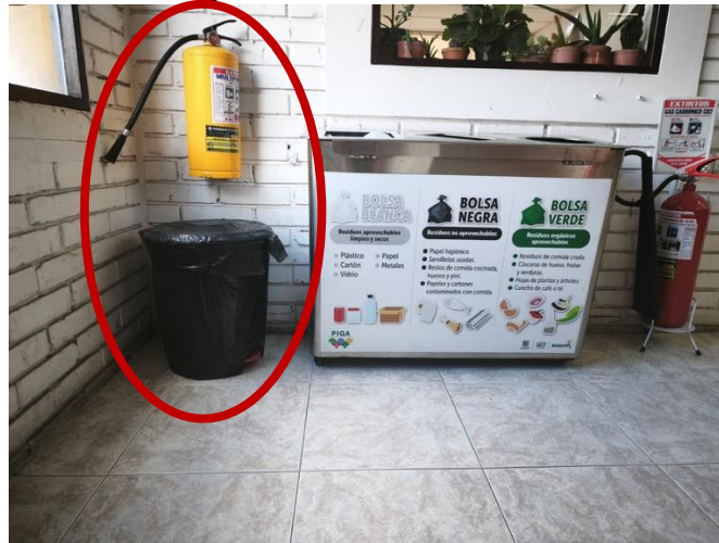
Imagen 9 Identificación de extintor
