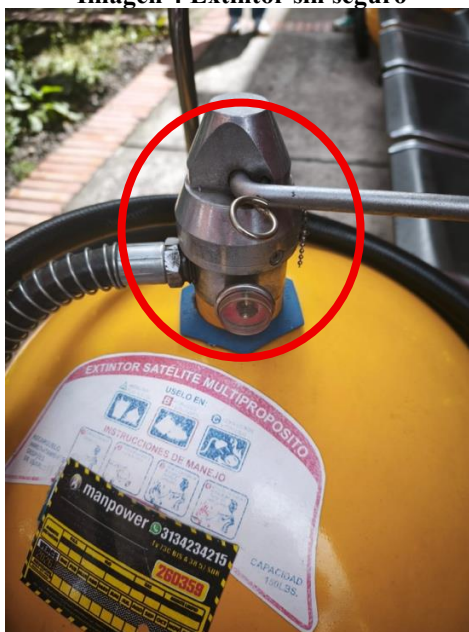
Imagen 4 Extintor sin seguro
