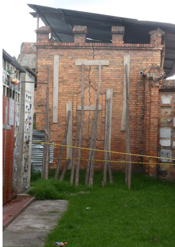
RIESGO INMINENTE POR FACHADA COLAPSADA C SUR
