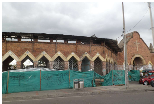
VULNERACIÓN A LA SEGURIDAD FACHADA COLAPSADA C SUR
