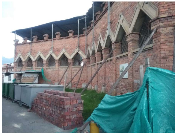
RIESGO INMINENTE POR FACHADA C SUR
