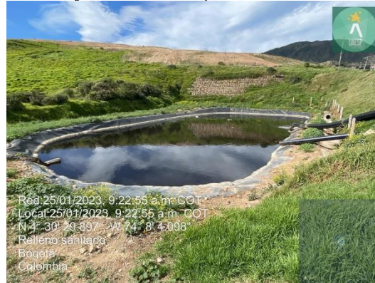
Imagen. Estado Actual de Pondaje Secador de Lodos
