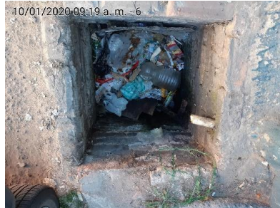
Ilustración 7: La caja de inspección externa se encuentra con residuos sólidos.
