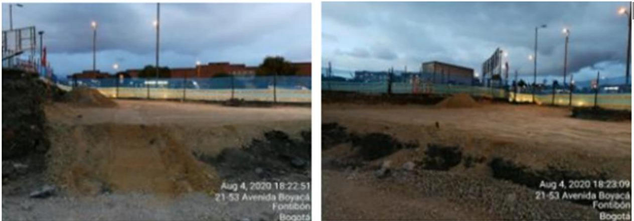
Ilustración 23: Proceso de reutilización en obra con material procedente de CTA. Proyecto Urbanismo La Felicidad. PIN 16668
