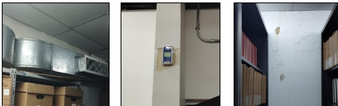
FIGURA 4 INSTALACIONES ARCHIVO CENTRAL
