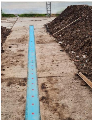
Figura 14 Sistema de aireación forzada
