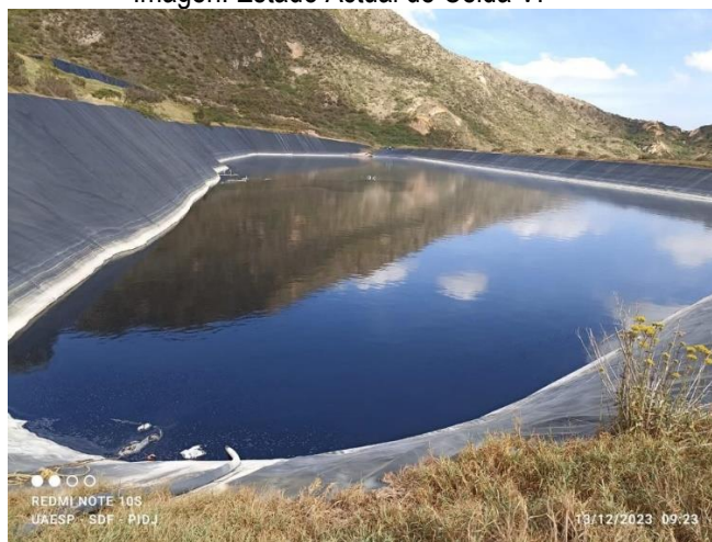
Imagen. Estado Actual de Celda VI
