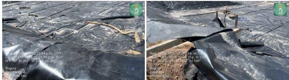
Imagen. Estado Actual de Pondajes II
