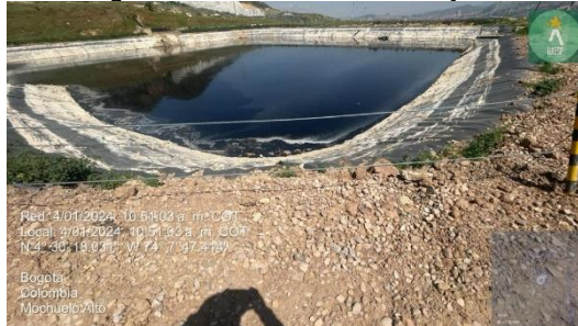
Imagen. Estado Actual de Pondajes II-1
