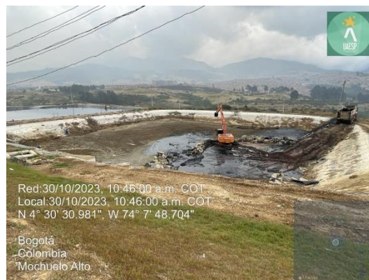
Imagen. Estado Actual de Pondajes II
