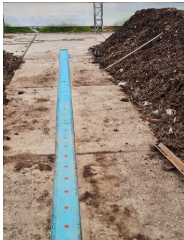
Figura 16 Sistema de aireación forzada
